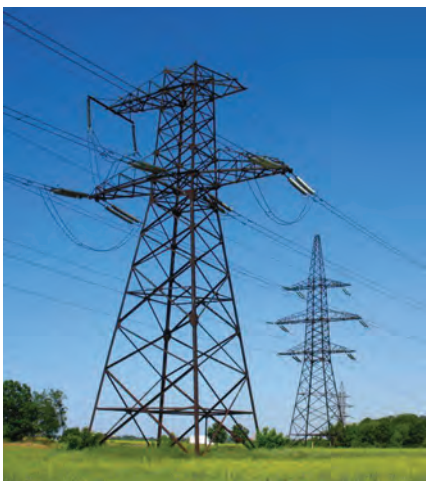
Опори ліній електропередачі
